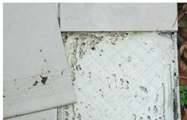
Przepuszczanie wody przez fugi skutkuje oderwaniem się płytek od warstwy kleju.
